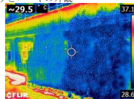
サーモグラフィーによる比較
